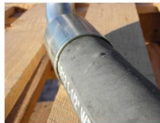
Preparação incorreta para prensagem de terminal
