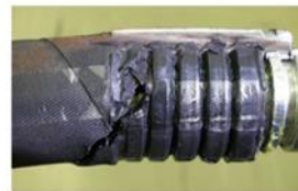
Ruptura da mangueira na base da conexão
